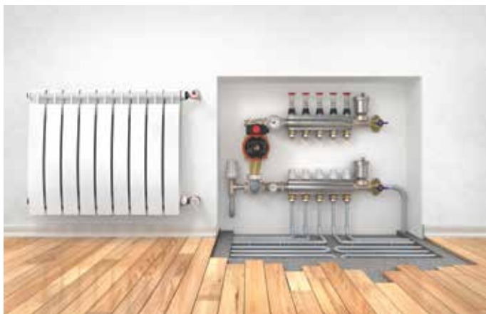
Radiátorovým i podlahovým vytápěním
